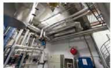
LIGNE DE FILTRATION CRÉMATORIUM / Bonneville
